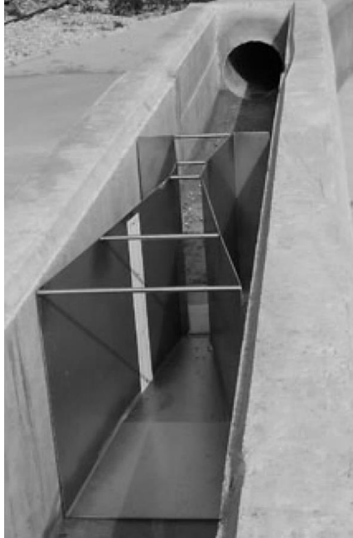
Figura 78. Canal Parshall metálico
