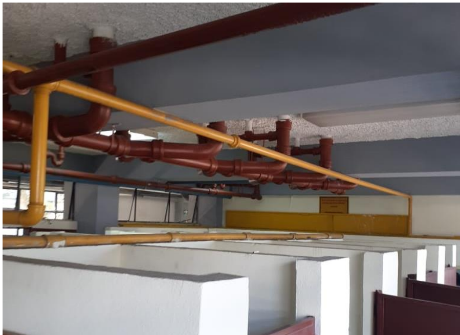
Figura 11. Tubería de suministro de agua de los baños del T3
