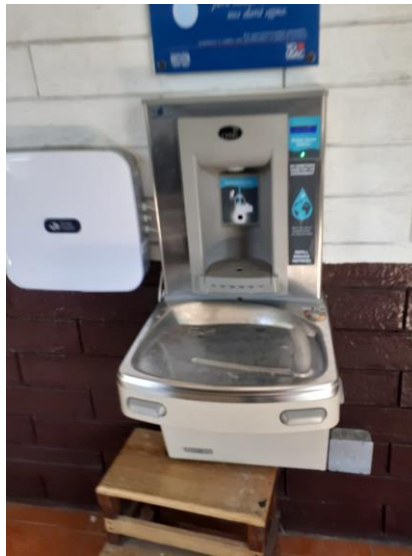
Figura 29. Nuevo sistema de filtrado de agua
