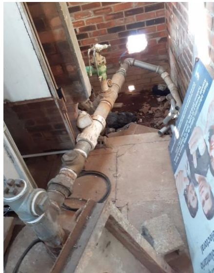
Figura 13. Tubería, accesorios y válvulas conectadas directamente a pozo uno
