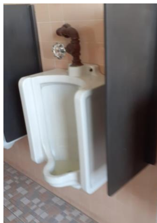
Figura 23. Antiguos mingitorios de los baños de hombres del edificio T3, con llave de descarga de agua
