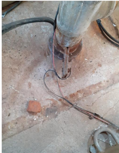
Figura 20. Cableado de alimentación eléctrica de bomba uno
