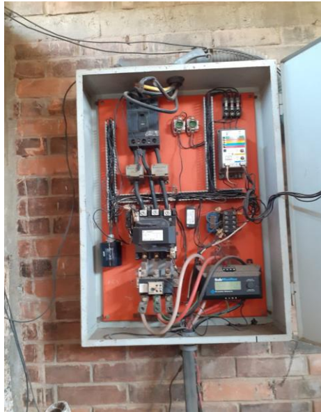
Figura 17. Tablero de control, distribución y alimentación de las bombas
