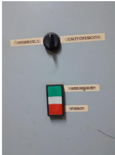
Figura 19. Control de arranque manual/automático de bombas
