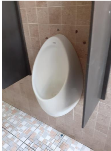
Figura 24. Nuevos mingitorios de los baños de hombres del edificio T3, sin llave de descarga de agua
