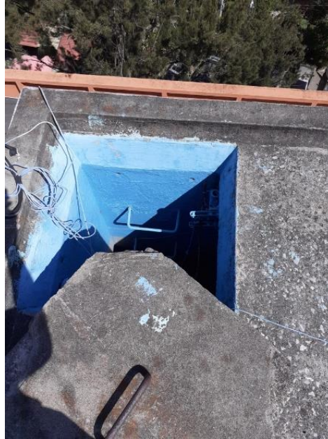
Figura 32. Acceso a tanque de almacenamiento y distribución
