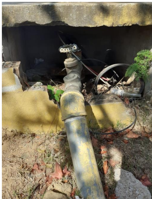
Figura 15. Llave de paso, tubería y accesorios de conexión a pozo dos
