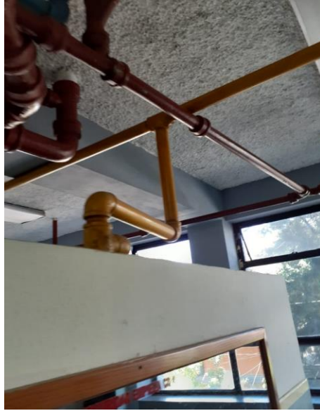
Figura 12. Tubería y accesorios de suministro de agua edificio T3
