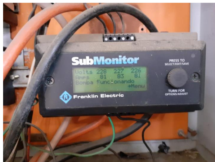
Figura 18. Monitor de funcionamiento de bombas
