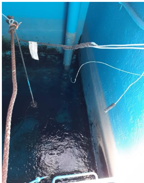
Figura 31. Interior del tanque de almacenamiento y distribución
