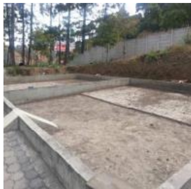
Figura 9. Patio de secado de lodos
