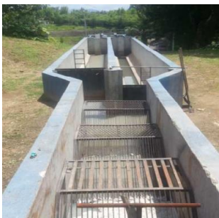
Figura 4. Cámara de rejillas
