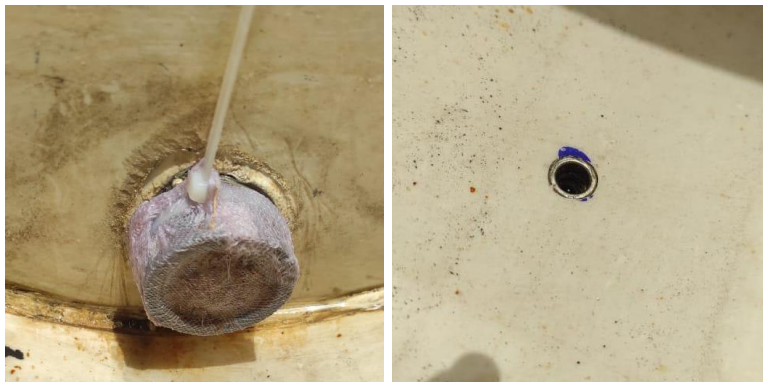
Figura 44. Filtro para la entrada de agua al sistema y válvula de drenaje
