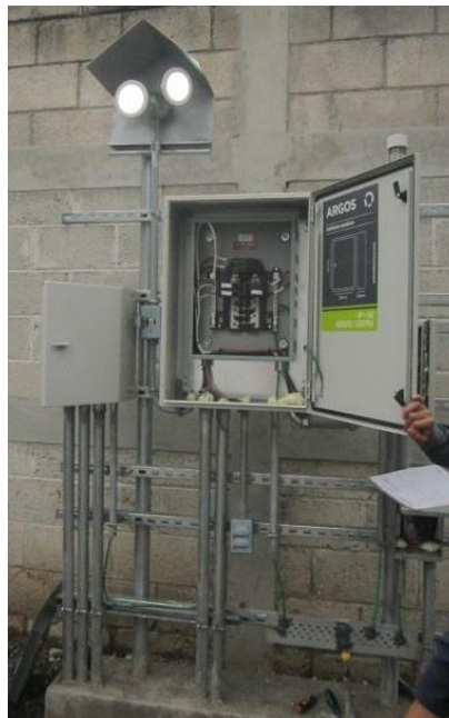
Figura 34. Iluminación sobre mampara
