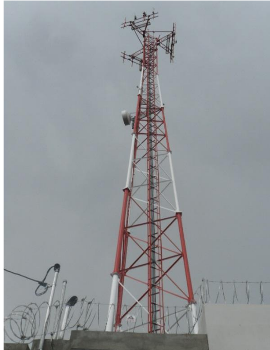
Figura 2. Estructura autoportada tipo triangular
