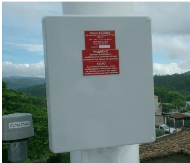
Figura 35. Fotocelda y caja de control de luces de navegación aérea
