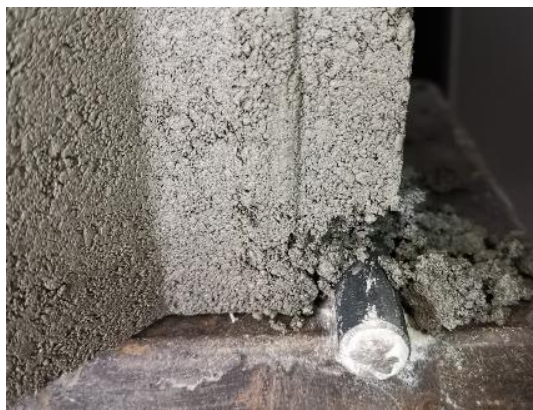
Figura 33. Ruptura de los adoquines en las esquinas inferiores
