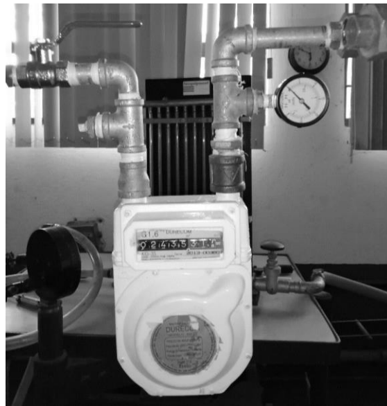
Figura 23. Medidor volumétrico de flujo
