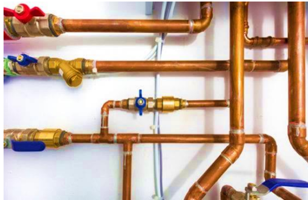
Figura 7. Tuberías de cobre en instalaciones hidráulicas
