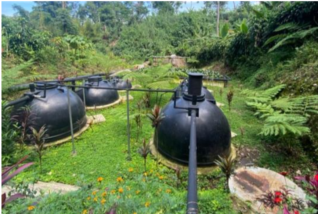
Figura 12. PTAR No. 2 de aldea Mi Tierra
