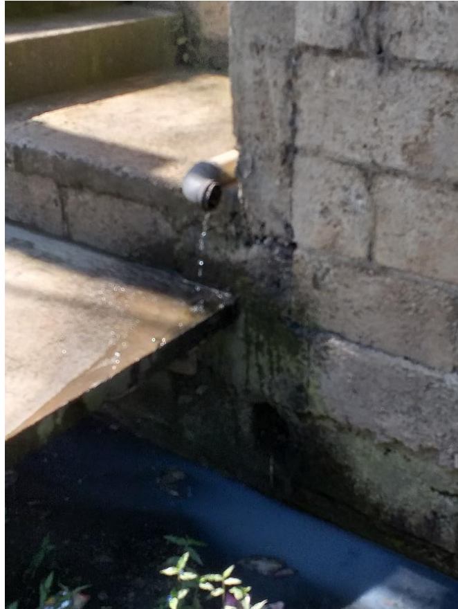
Figura 115. Goteo de aguas grises
