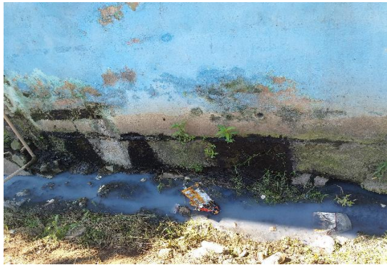
Figura 116. Aguas grises expuestas y humedad en muro
