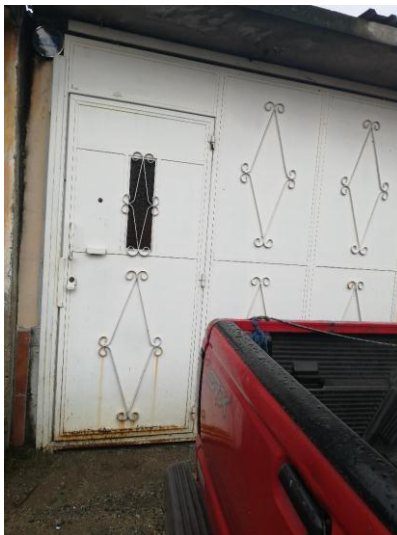
Figura 128. Óxido en puerta de metal
