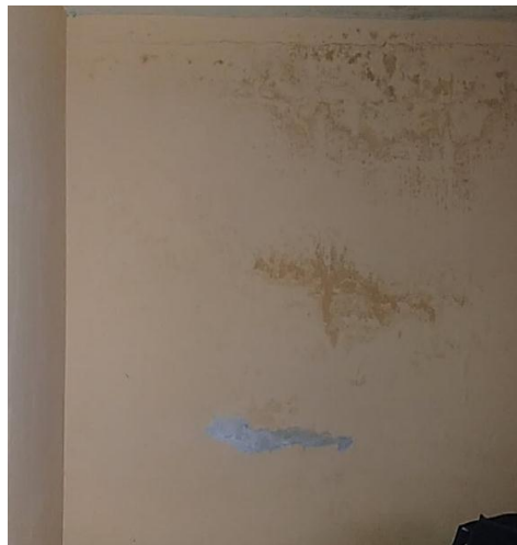
Figura 132. Humedad en muro
