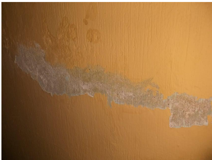
Figura 133. Muro con salitre
