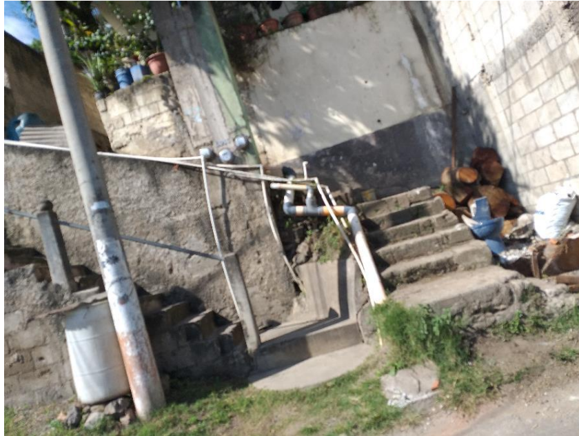
Figura 134. Tubería de PVC expuesta al sol
