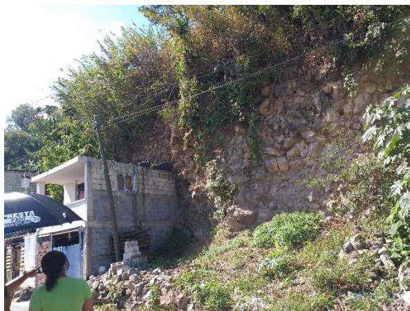
Figura 120. Viviendas bajo barrancos
