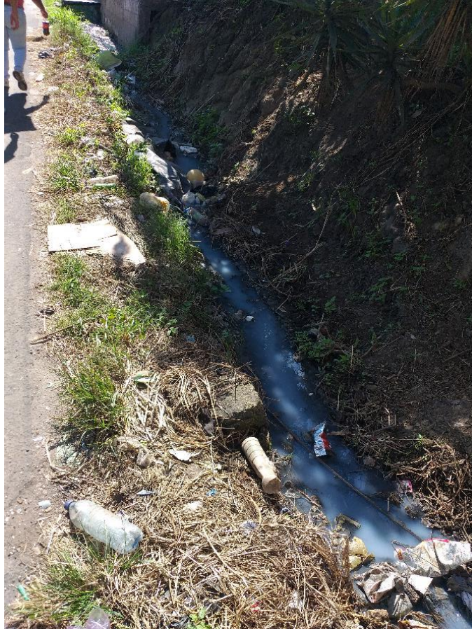
Figura 113. Aguas residuales expuestas
