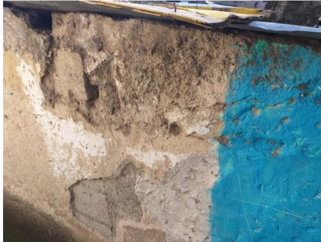
Figura 131. Desgaste de muro
