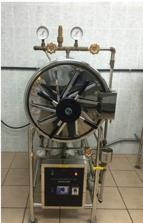
Imagen 1. Autoclave 1 De la Unidad de Esterilización
