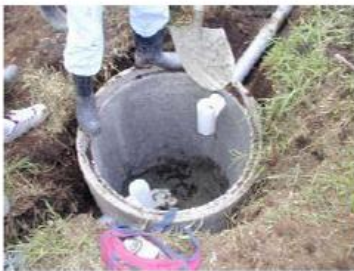
Tratamiento preliminar. Trampa de grasas y partículas gruesas
