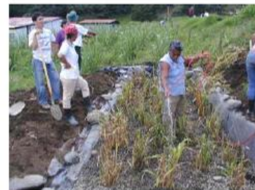
Plantas colocadas sobre el lecho filtrante
