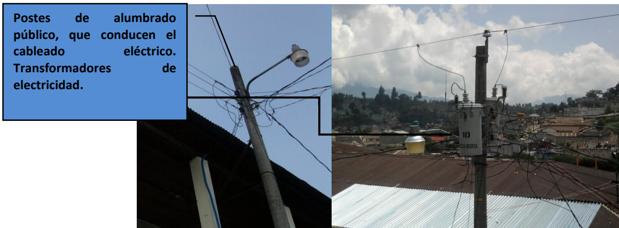
Fotografía 49. Servicios básicos. Alumbrado público y servicio de energía eléctrica. Fuente: Fotografía propia, Junio 2012.
