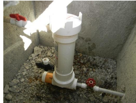
Fotografía 24. Filtro donde se clora el flujo de agua.
