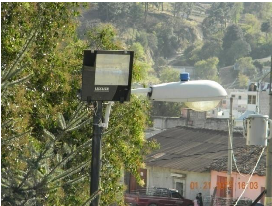
Fotografía 28. Alumbrado público en el parque central de la cabecera municipal.
