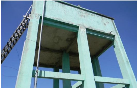
Fotografía 23. Tanque de almacenamiento, cabecera municipal.
