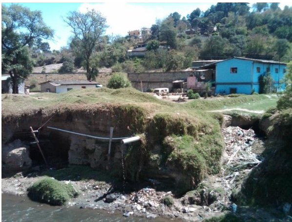
Fotografía 26. Desfogue de aguas negras hacia el río Xequijel.
