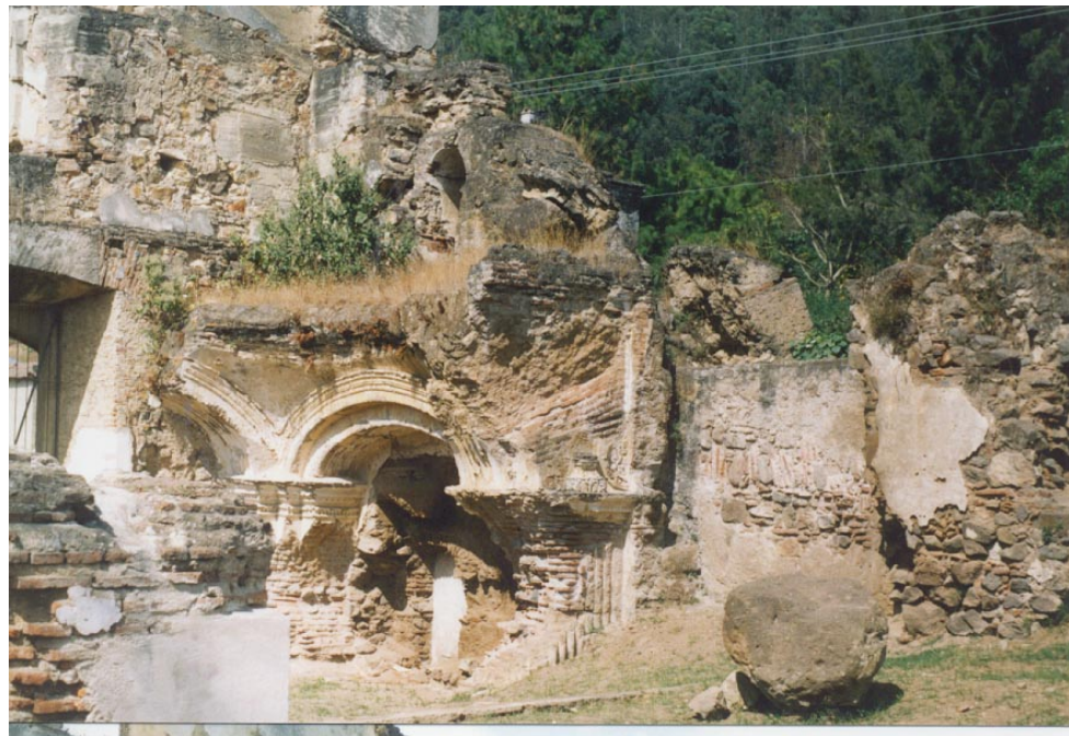
Foto 16: Presencia de uno de los muros de la entrada principal con daños bastante pronunciados.
