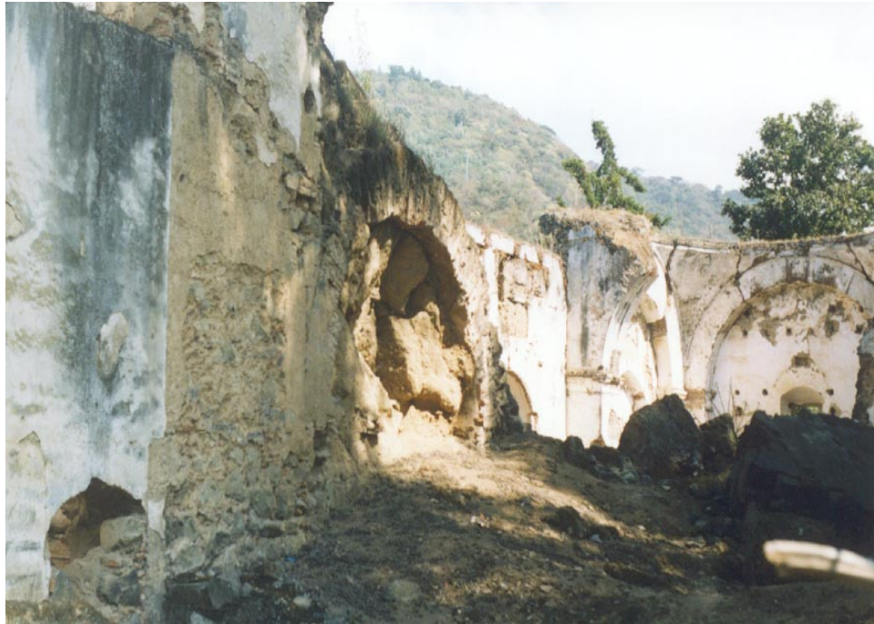
Foto 17: Presencia de ripio dentro del monumento, así como también daños en sus muros.
