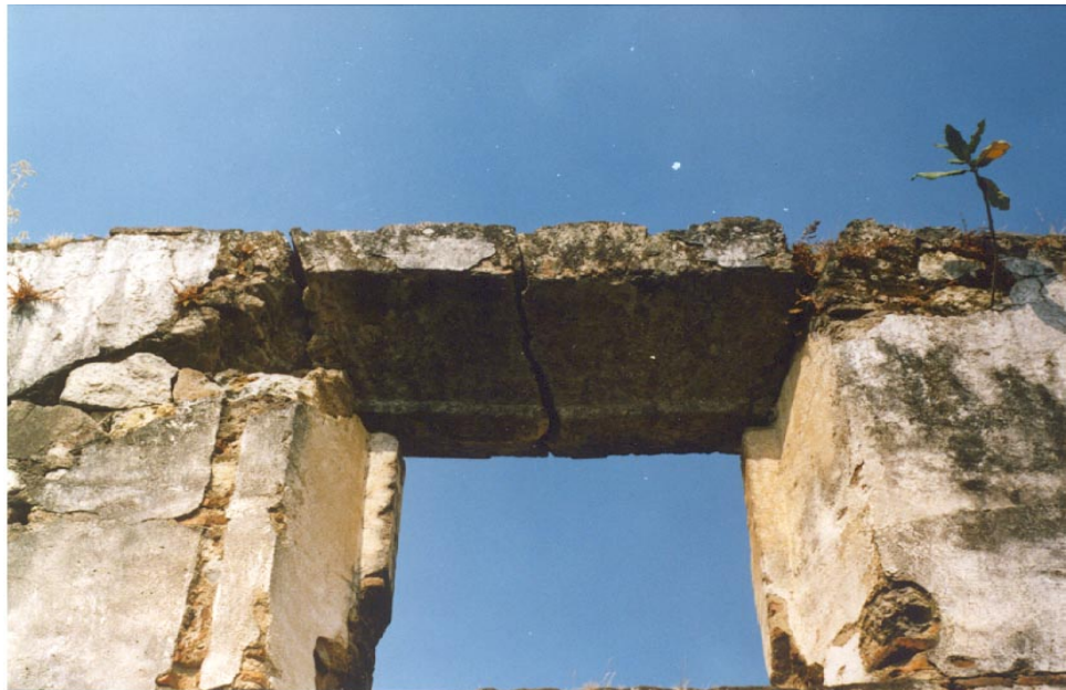
Foto 4: En uno de los ventanales del Convento el dintel a punto de colapsar.
