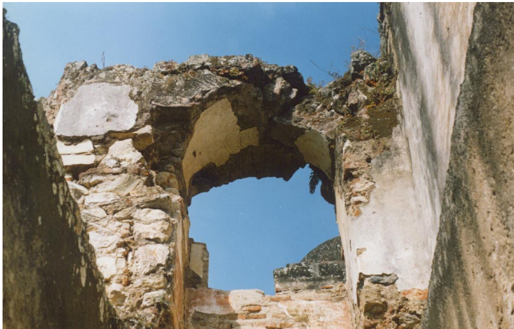
Foto 14: Vista de una de las ventanas a punto de colapsar
