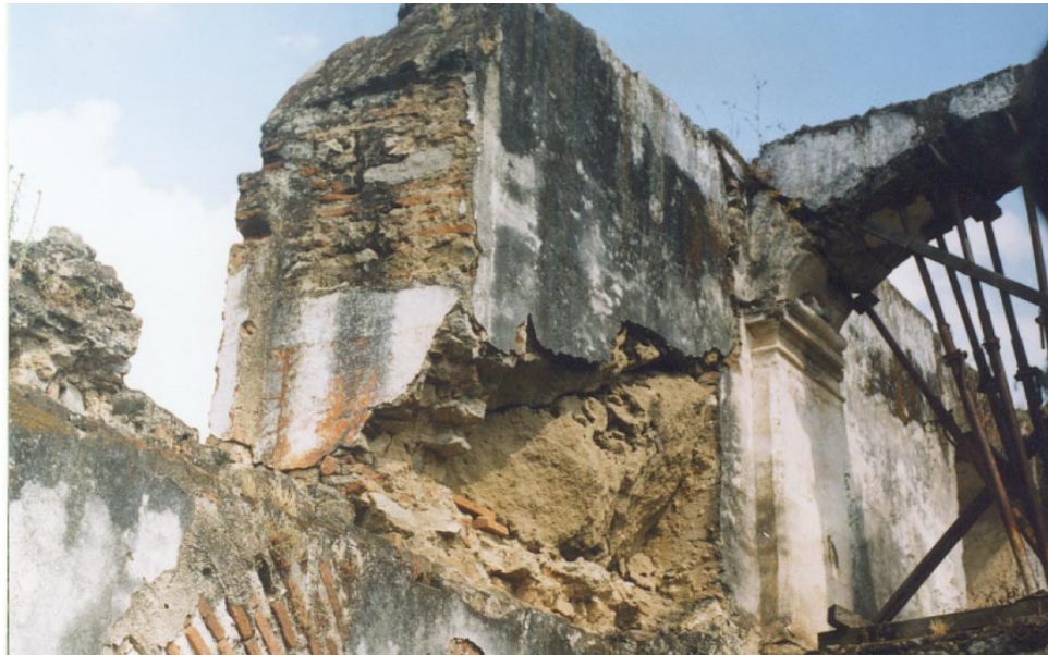
Foto 2: Ausencia de parte del muro y cuñas que ayudan parte del arco que no colapse, el mal estado hace que el monumento se dañe debido a la intemperie.
