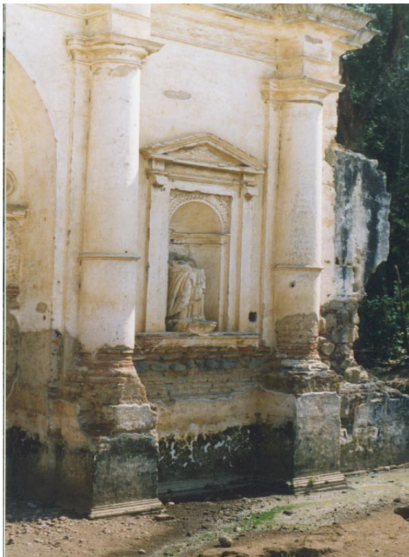
Foto 18: Vista de la fachada del Templo de los Remedios, daños causados por la intemperie y por los fenómenos naturales.
