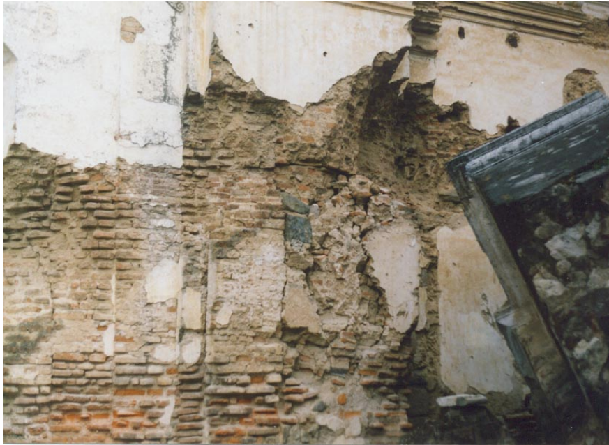
Foto 5: Vista de daños en una de las columnas del Convento de la Concepción, al costado derecho se observa una de las columnas caídas a causa de los terremotos.
