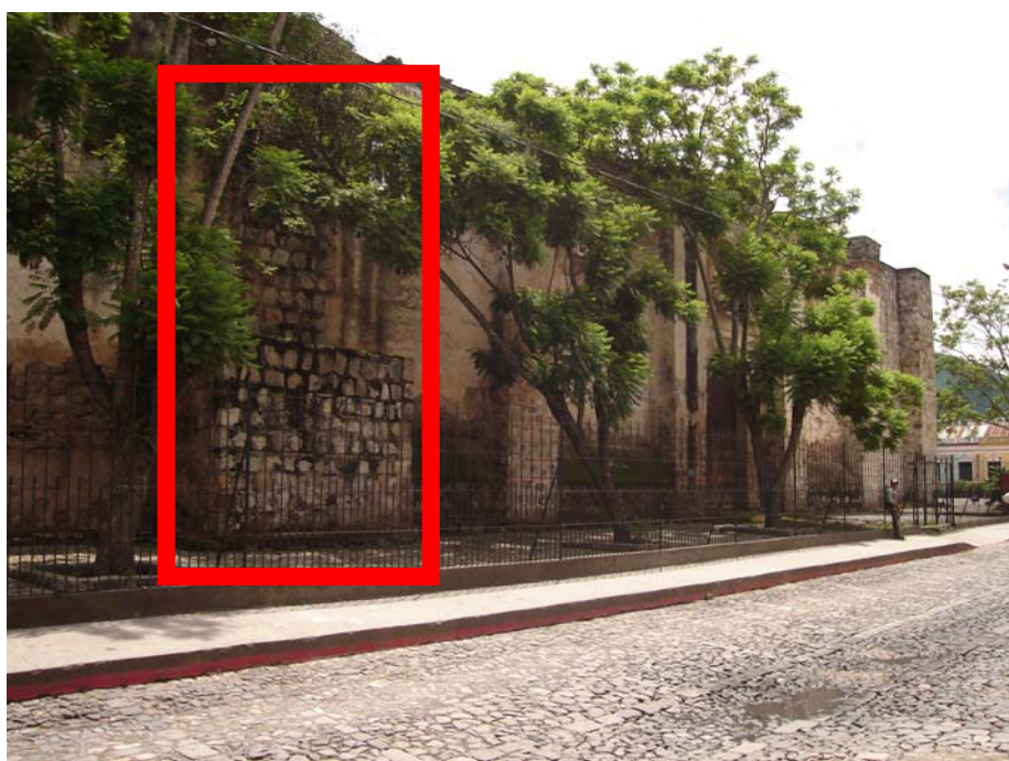
Foto 34: La Compañía de Jesús, sufrió daños después de soportar varios terremotos entre los cuales podemos mencionar el de 1695, cuando se deterioro el convento posteriormente en 1717, especialmente la casa conventual, y sus paredes.
