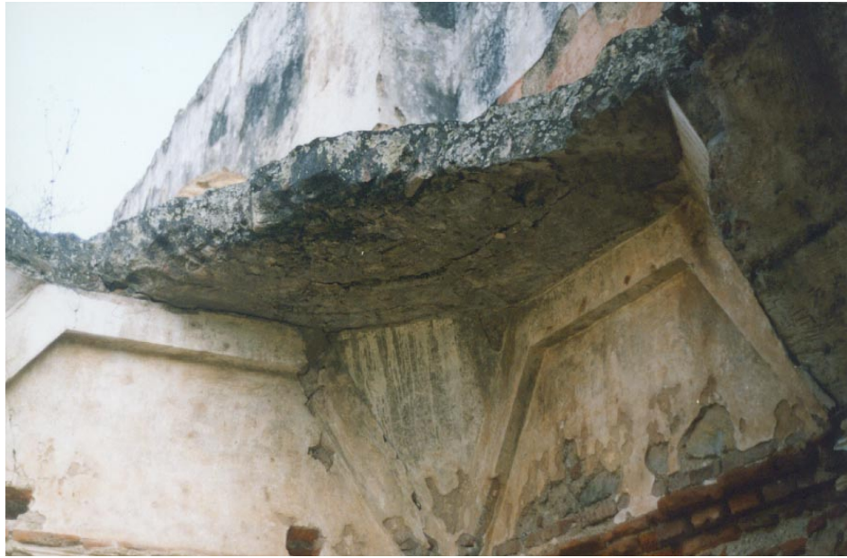
Foto 13: Techos dañados y descuido en el mantenimiento del Convento y aun puede verse la consistencia de los materiales a pesar de los fenómenos ocurridos a través de los siglos
