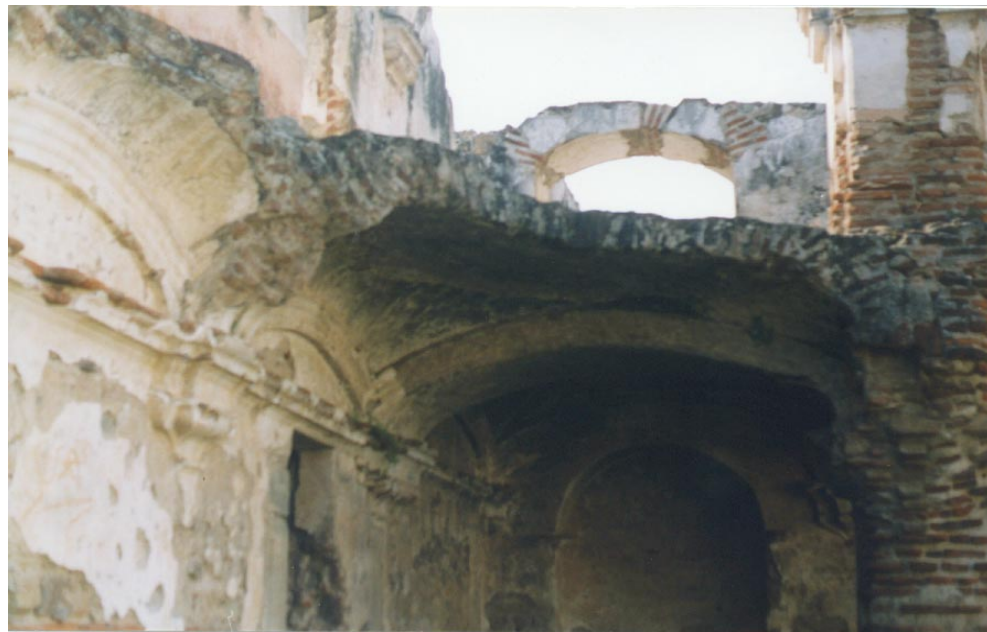
Foto 12: En esta fotografía del Convento de la Recolección se ve el deterioro del estuco de las paredes, así mismo en las columnas y en las bóvedas
