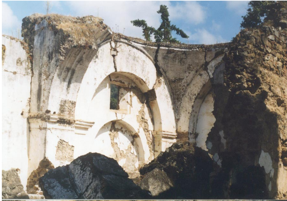
Foto 19: Ausencia de bóvedas, también puede verse las columnas destruidas en la parte interior del monumento.
