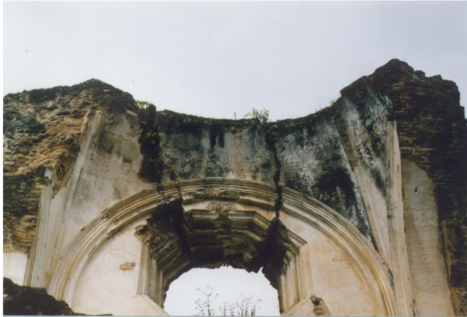
Foto 7: Algunas partes del monumento aún se encuentran en riesgo de colapsar
