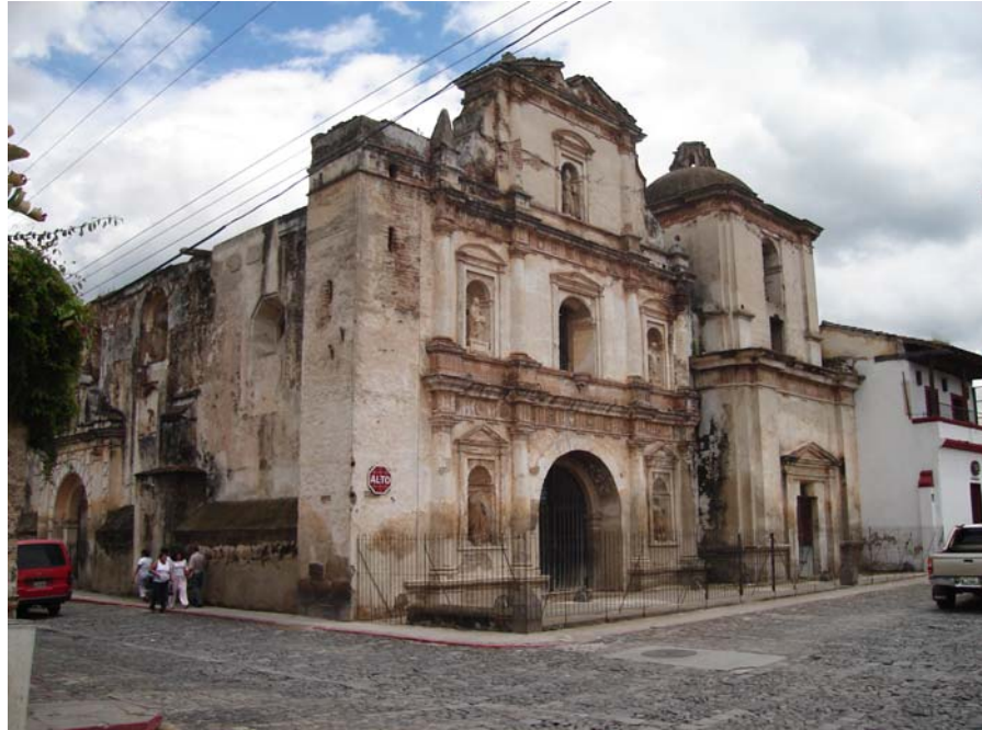
Foto 29: El Convento de San Agustín, por las descripciones del Arquitecto Diego de Porres en su obra menciona que encontró que se había rajado el cuerpo de la iglesia y la capilla mayor, lo cual pueden haber indicios de los cambios anteriormente mostrados.
