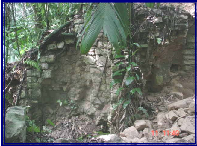
Fig. 10 – Cámara 1 y 3 de estructura B8, mostrando su alto grado de destrucción.
