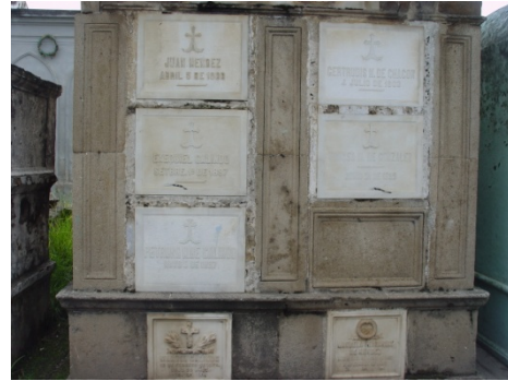
Mausoleo de la familia Méndez, obsérvese la piedra destruida, año 2,006, fotografía de investigador.
