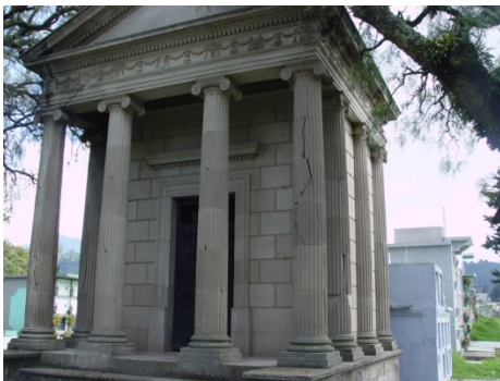
Mausoleo con rajaduras en sus columnas, peligro latente para los visitantes y obra arquitectónica a punto de desaparecer, año 2,006, fotografía del investigador.
