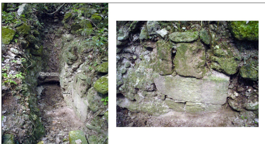
Figura 4.47 a) Túnel de saqueo en la Estructura 2B3-5, Grupo Xiboj; b) Detalle de un muro de jamba (Fotos: C. Morales-Aguilar).
