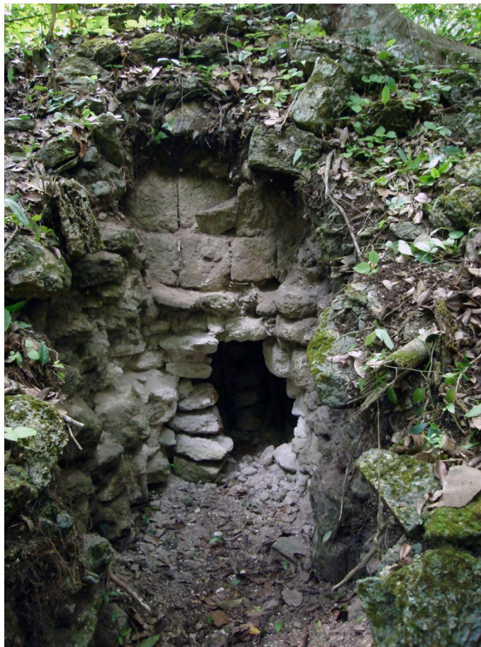
Figura 4.20 Vista de un muro interior de la Estructura 2A9-1, Grupo Venado (Foto: C. Morales-Aguilar).
