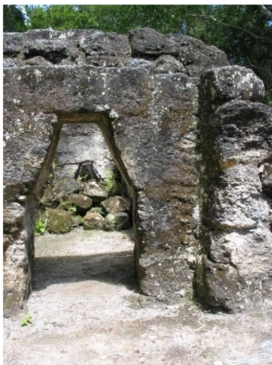
Figura No. 88, Edificio 5D-91. Vista de Este a Oeste, mostrando el arco falso de la bóveda y su sistema constructivo. Imagen tomada por Gómez 2007.
