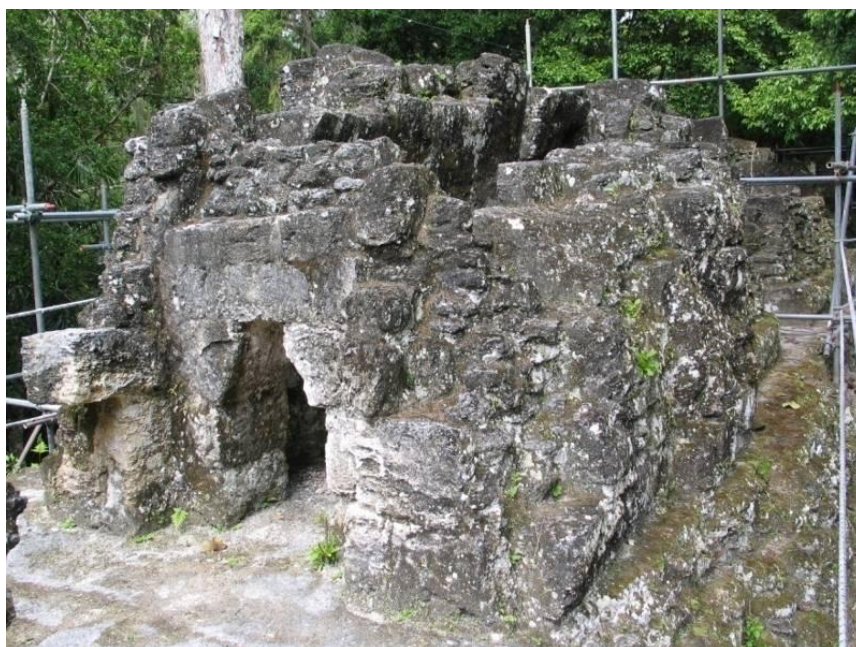
Figura No. 89, EDIFICIO 5D-91. Vista del sistema constructivo de la bóveda en saledizo, con vista de Este a Oeste. Imagen tomada por Gómez 2007
