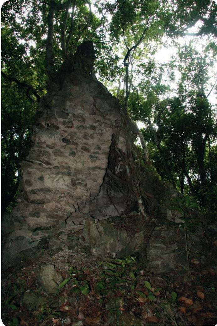
Figura III.53. Crestería a punto de colapsar de la Estructura 4, Grupo 46, El Resbalón (Foto A. Girón; © Proyecto Cuenca Mirador-FARES)
