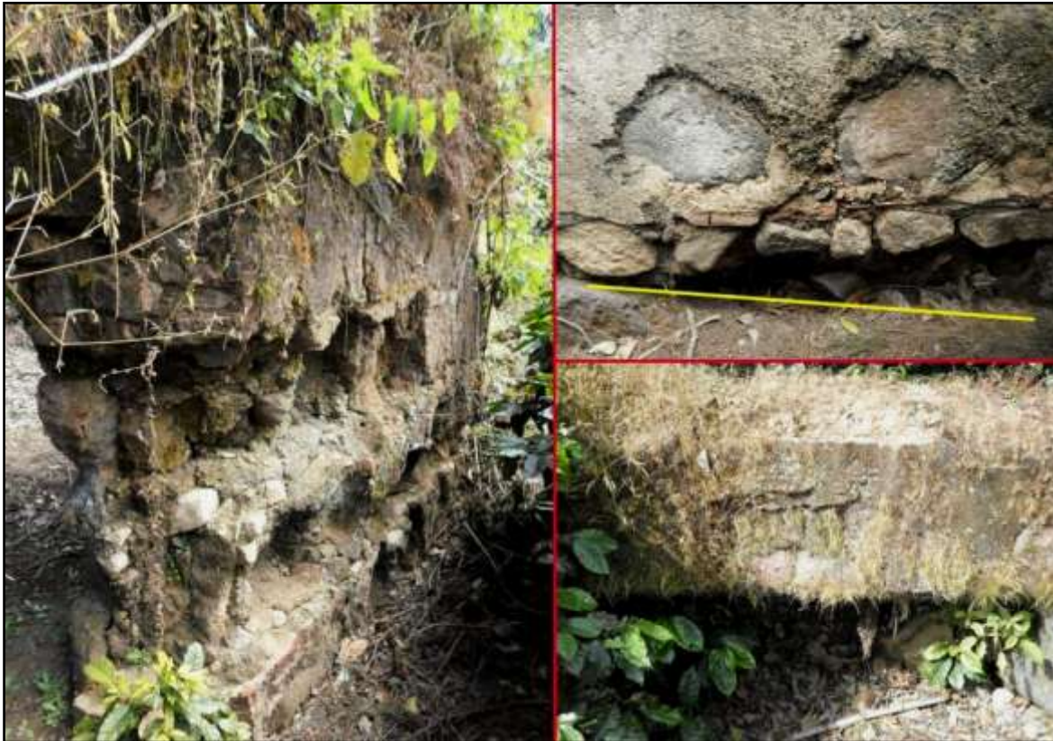
Figura 42: La filtración de la lluvia que se queda goteando en los helechos va permeando y destruyendo paulatinamente la pared de la fachada norte de la casa, imagen de la izquierda. El socavamiento de las bases de la fachada sur de la casa es debido a la erosión que causa el paso de la corriente de la lluvia, arriba, derecha. Gran cantidad de material terroso es arrastrado por la lluvia, lo que va recubriendo los muros, abajo, derecha. (Fotografía: Sosa, 2014).
