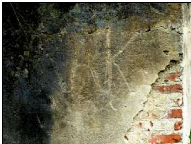
Figura 48: Un grafiti con las iniciales “AK” en las paredes de la casa es la única evidencia de vandalismo, las letras ya tenían aspecto de no ser un daño ocasionado recientemente (Fotografías: Sosa, 2014).
