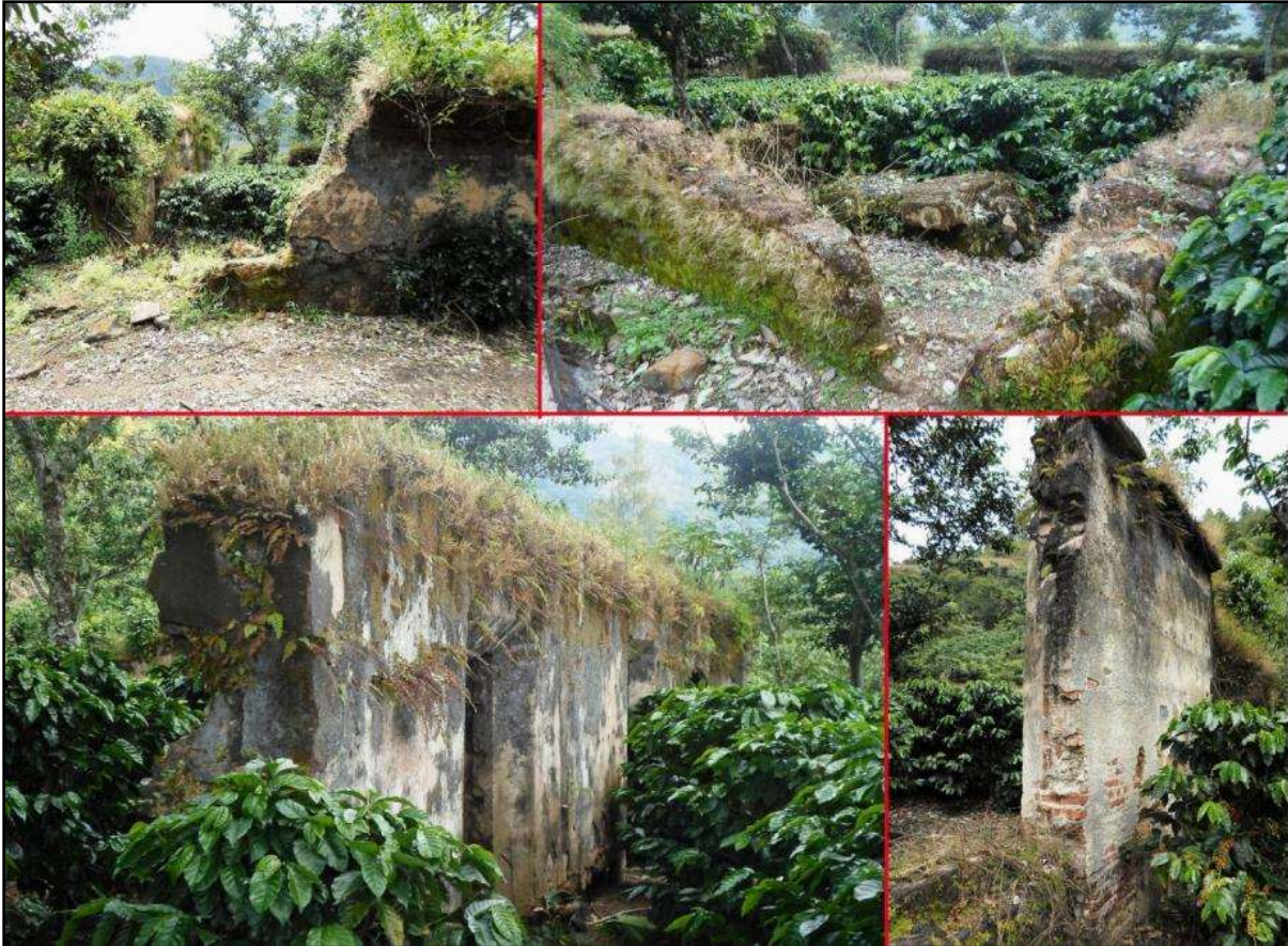
Figura 46: Otros ejemplos de daños que posiblemente hayan tenido un origen sísmico. Obsérvese que todas las imágenes son de las cuatro esquinas de la casa, en donde el deterioro estructural es el rasgo común (Fotografías: Sosa, 2014).
