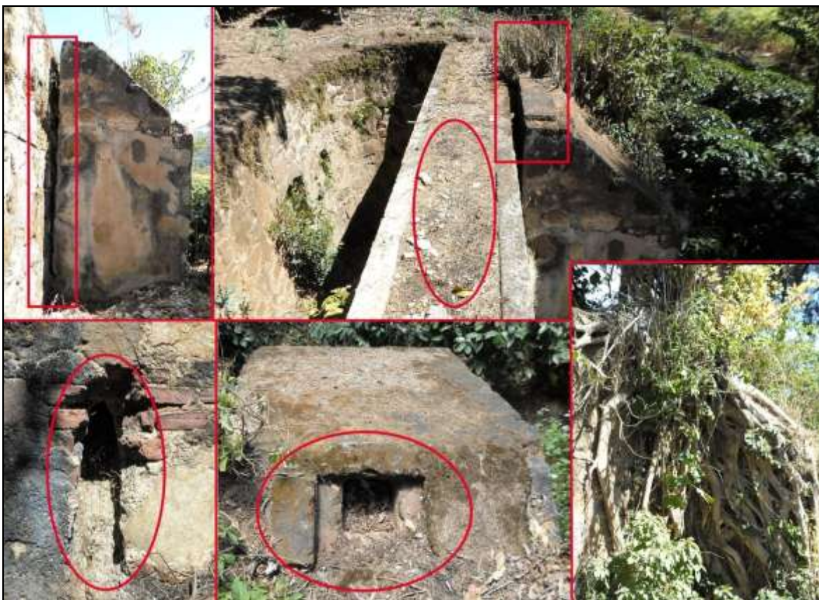
Figura 40: Características hidráulicas y estructurales del muro de contención. Nótese el sistema hidráulico implementado sobre el muro perimetral y en algunos contrafuertes que están siendo afectados por el crecimiento de macroflora (Fotografía: Sosa, 2014).
