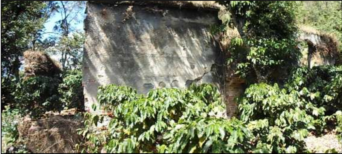
Figura 28: Imagen que evidencia el estado actual de la fachada este (Fotografía: Sosa, 2014).
