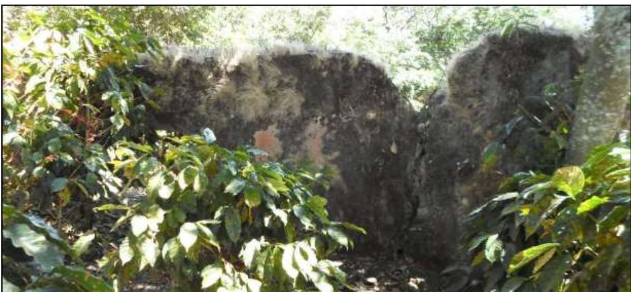
Figura 24: Toma fotográfica de los restos del muro en la fachada oeste, la más dañada de todas las paredes de la casa (Fotografía: Sosa, 2014).
