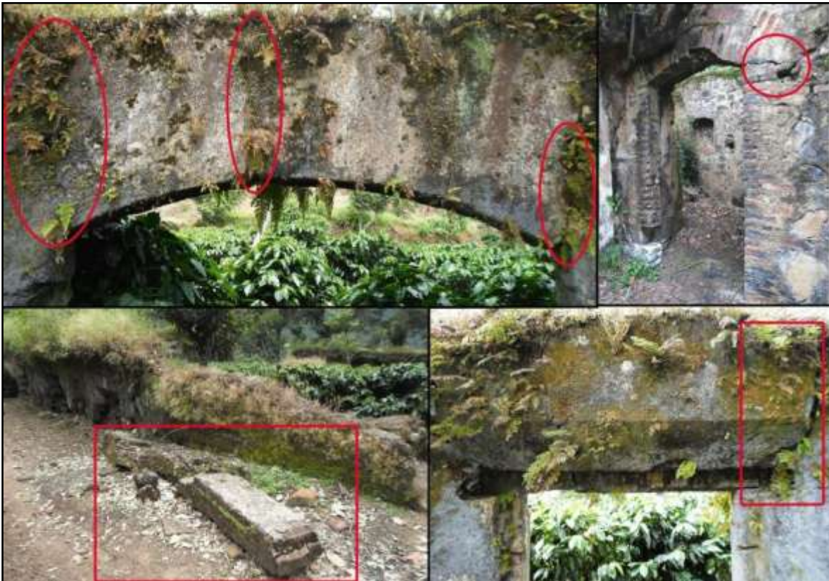
Figura 45: Los sectores deteriorados por causas sísmicas son apreciables en las fisuras de los puntos de uniones de los vanos de las puertas y ventanas. Abajo, izquierda, un fragmento de más de un metro de longitud del caveto de la fachada norte, posiblemente colapsado por factores relacionados con los sismos (Fotografías: Sosa, 2014).
