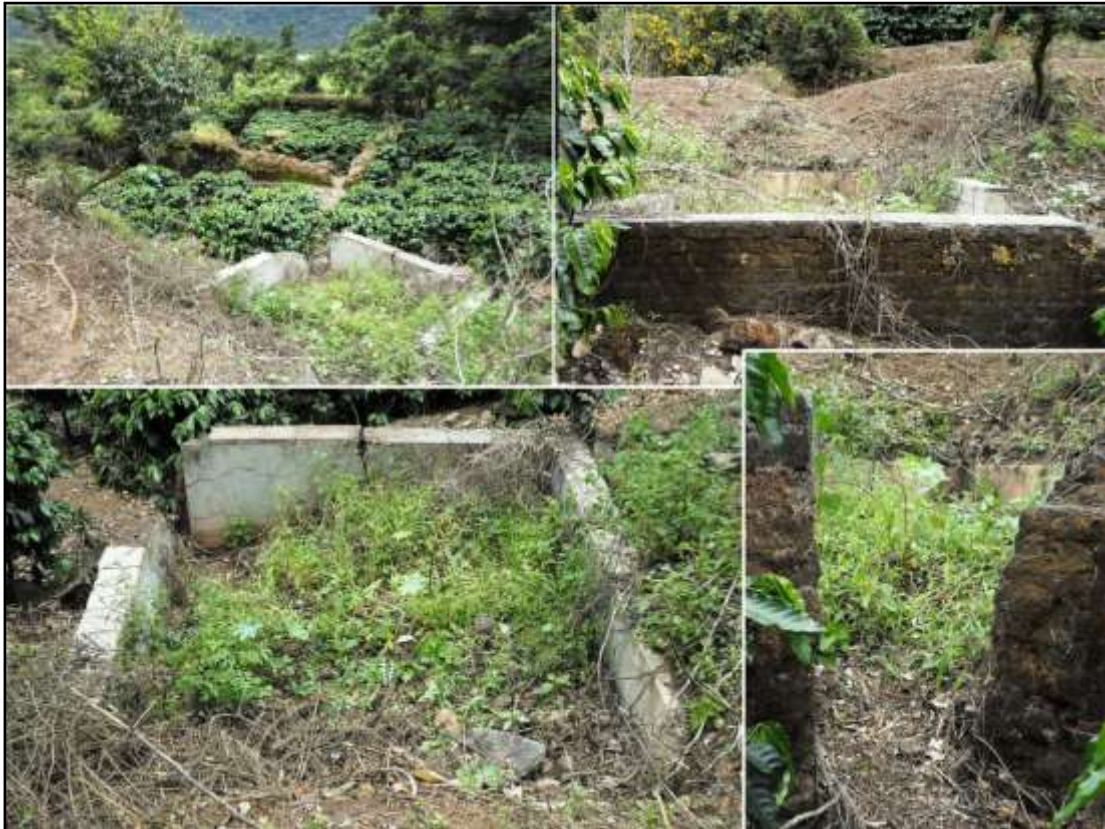
Figura 36. Rasgo 4: Tomas fotográficas que evidencian los diversos daños y el estado actual de la pileta (Fotografía: Sosa, 2014).
