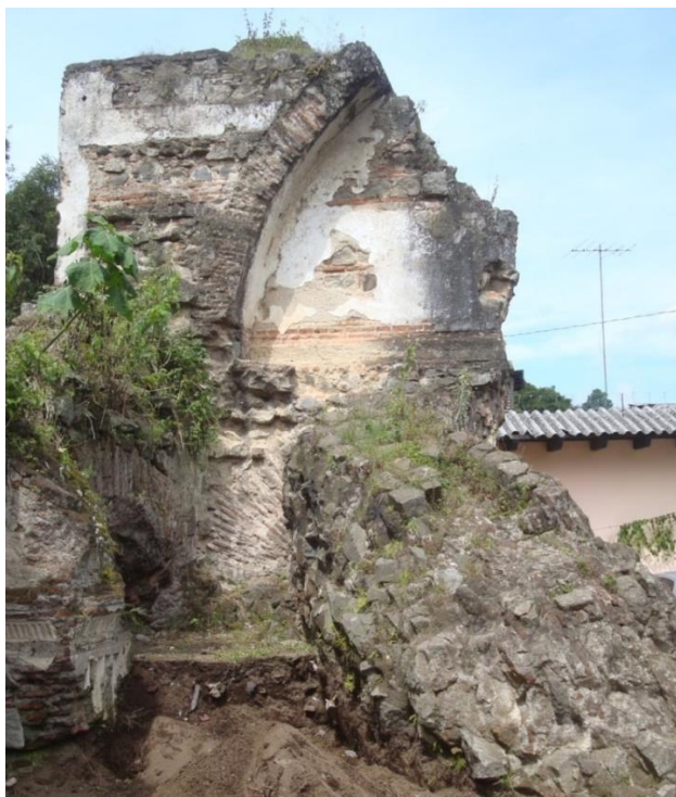
Figura 13 Coro en mal estado de conservación. Fotografía: Juan Pablo Herrera, 2012
