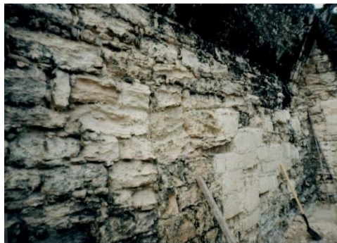
Imagen 3. muro central -oeste- deteriorado
