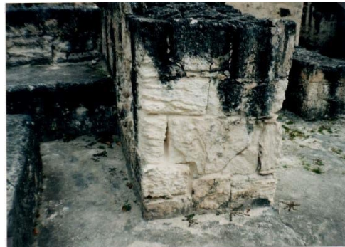
Imagen 5 Muro central - norte - deteriorado
