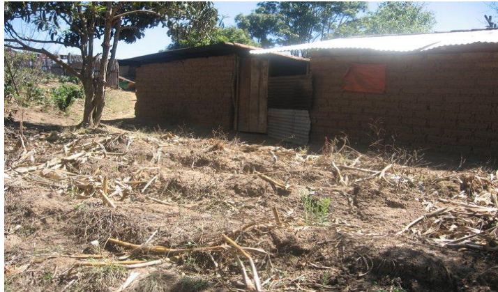
Casa con daños provocados durante la tormenta Agatha (2010)
