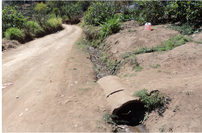
Fuente: Meeylyn Lorena Mejía López Drenajes. Otro foco de contaminación es la falta de drenajes en la Aldea Patzaj.
