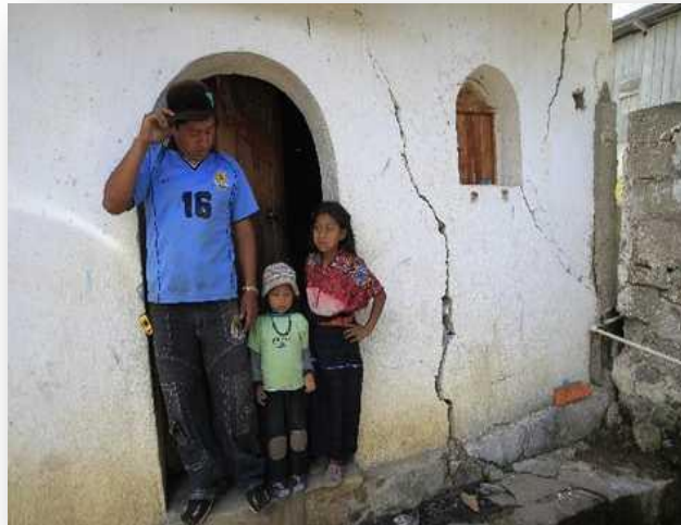
Casa dañada por los desastres del Huracán Mich en Antigua Santa Catarina Ixtahuacán
