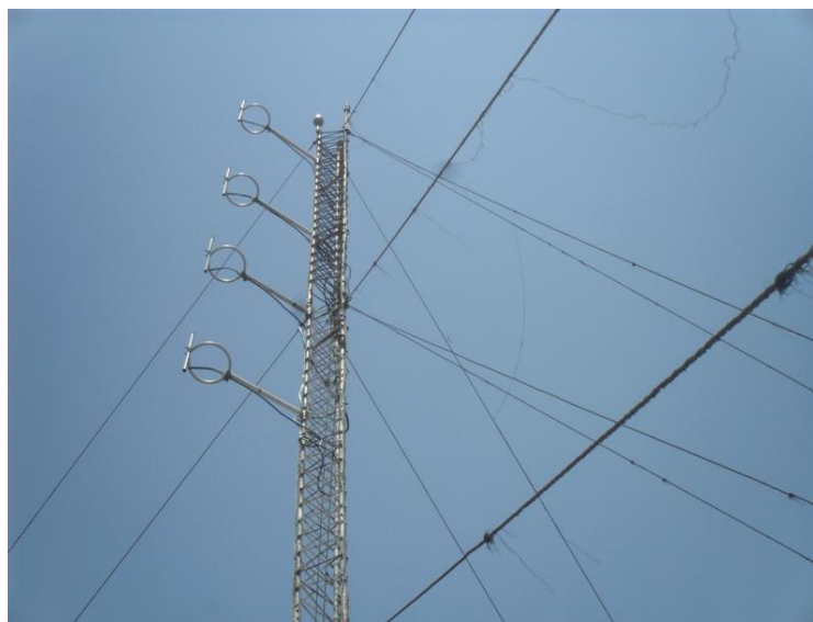
Torre donde están instalados los cuatros anillos (antenas)
