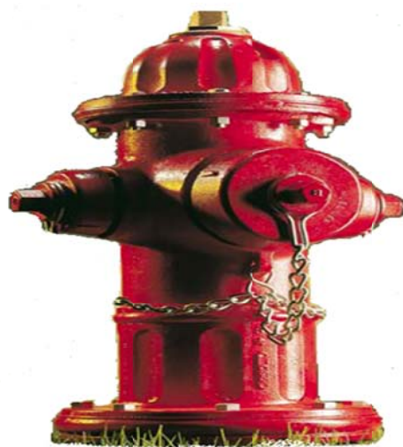
Hidrante se agua
