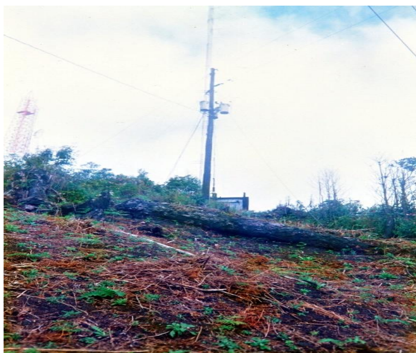
1997 Cerro Chicut Banco de transformación para la planta de transmisión. Archivo Tezulutlán
