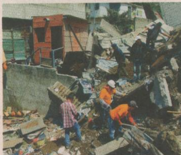
Destrucción y desolación se percibían en la colonia El Cambray II desde el amanecer cuando empezó el rescate. F. NADIA CABRERA
