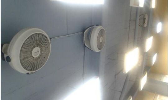
Ventilación de las oficinas centrales de Fundación AYUVI.
