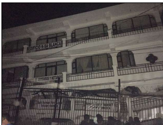
Fotografía 27. Daños en un edificio en Tacaná, San Marcos, por el fuerte sismo.
