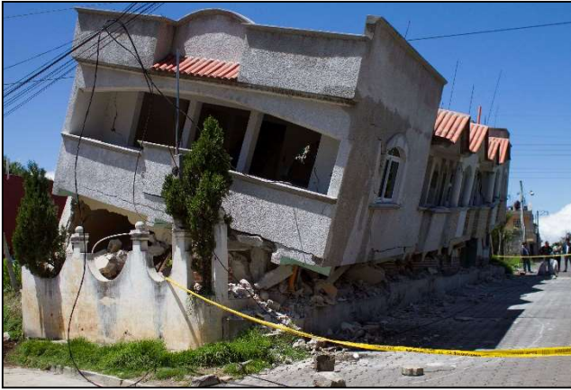
Fotografía 19. Daños en vivienda recién construida debido al uso de materiales no adecuados. CONRED.
