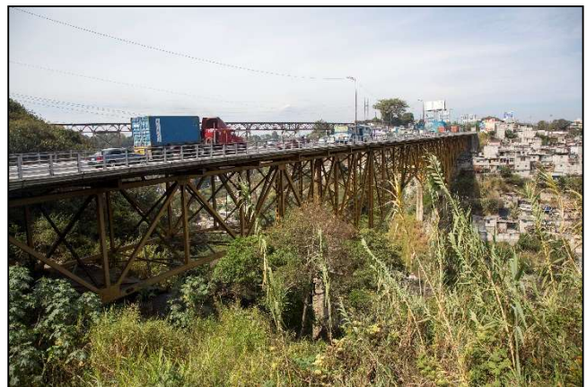
Fotografía 26. Puente Belice en el ingreso a la ciudad de Guatemala. CONRED.
