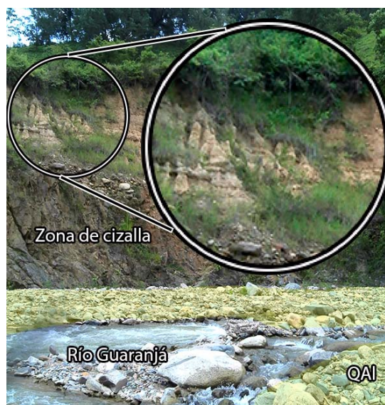
FOTOGRAFÍA 18 CÁRCAVAS EN LADERAS UBICADAS DEL RÍO GUARANJÁ
