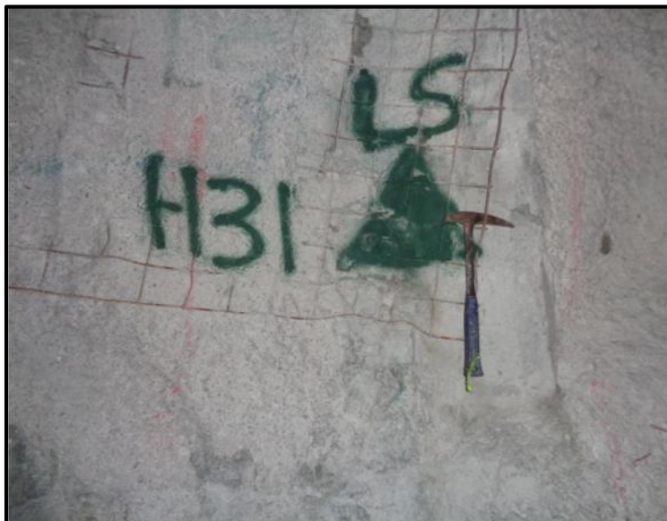
FOTOGRAFÍA 3 EJEMPLAR DE UN PUNTO DE CONTROL O LASER
