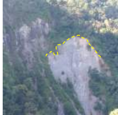
Deslizamiento en unida de Toba Lítica Tomada por: Michelle Boiton
