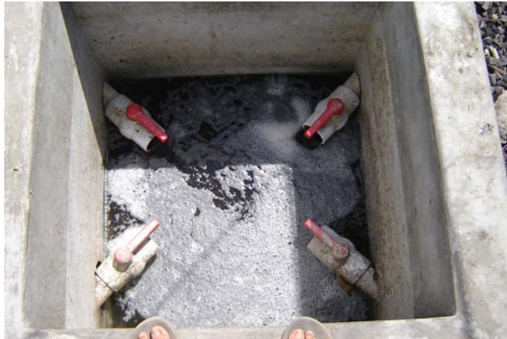
Figura No. 9 Drenaje de agua
