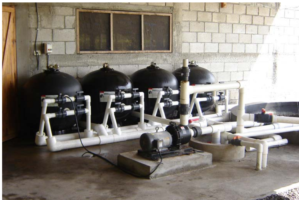
Figura No. 8 Filtros de carbón y bomba
