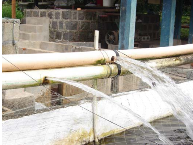
Figura No. 5 Tubería utilizada para la entrada de agua a los tanques.
