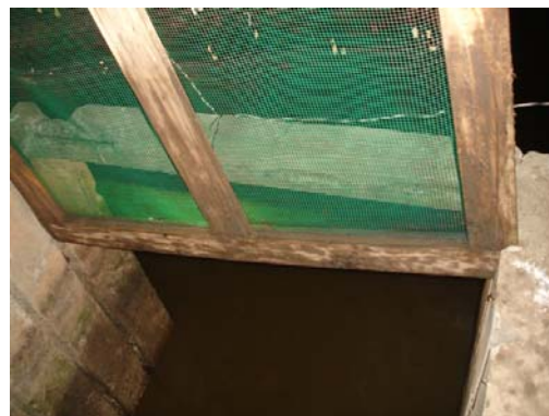
Figura No.13 Filtro de entrada de piscina
