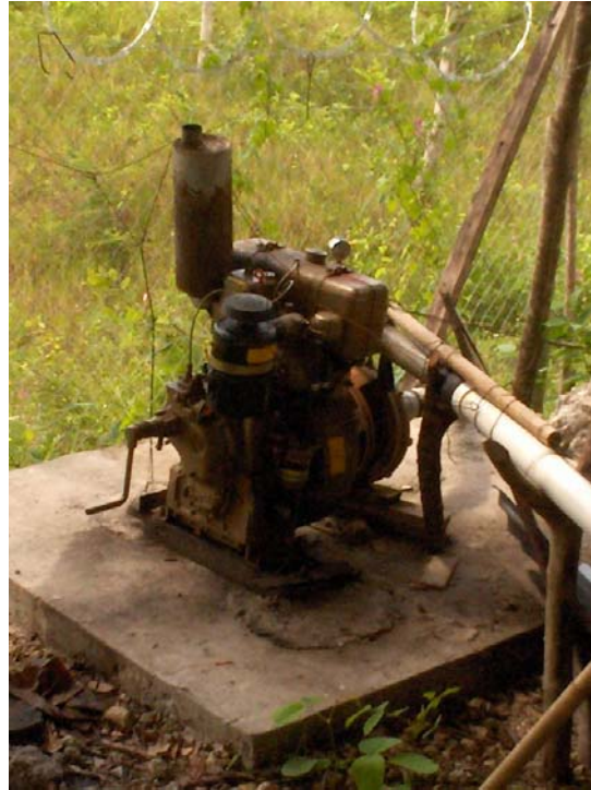
Anexo No. 35 Bomba de reserva succionadora de agua de 3 pulgadas
