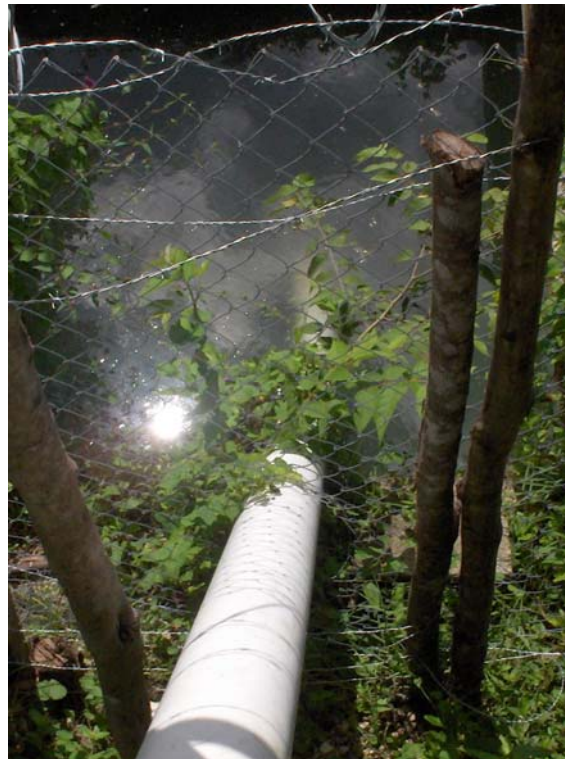
Anexo No. 36 Área de succión de agua del Lago Peten Itza
