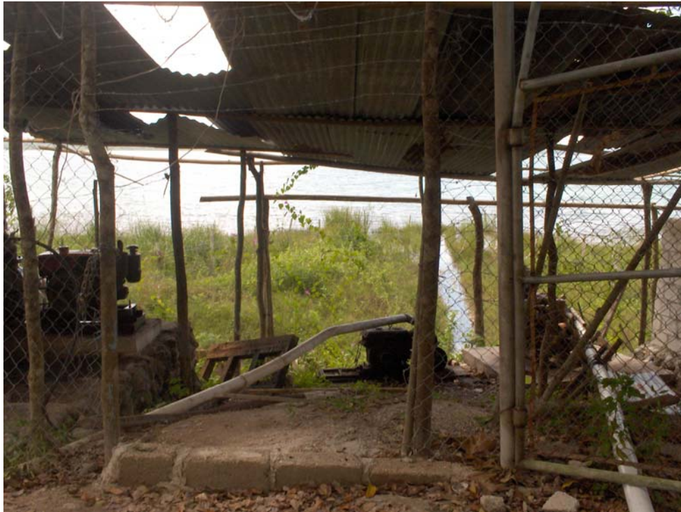
Anexo No. 33 Cuarto de bombas succionadoras de agua hacia el sistema de estanqueria
