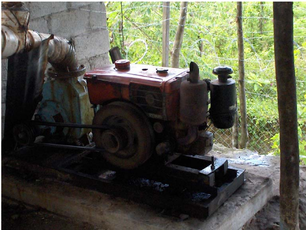
Anexo No. 34 Bomba de 6 pulgadas que abastece de agua al sistema de estanqueria
