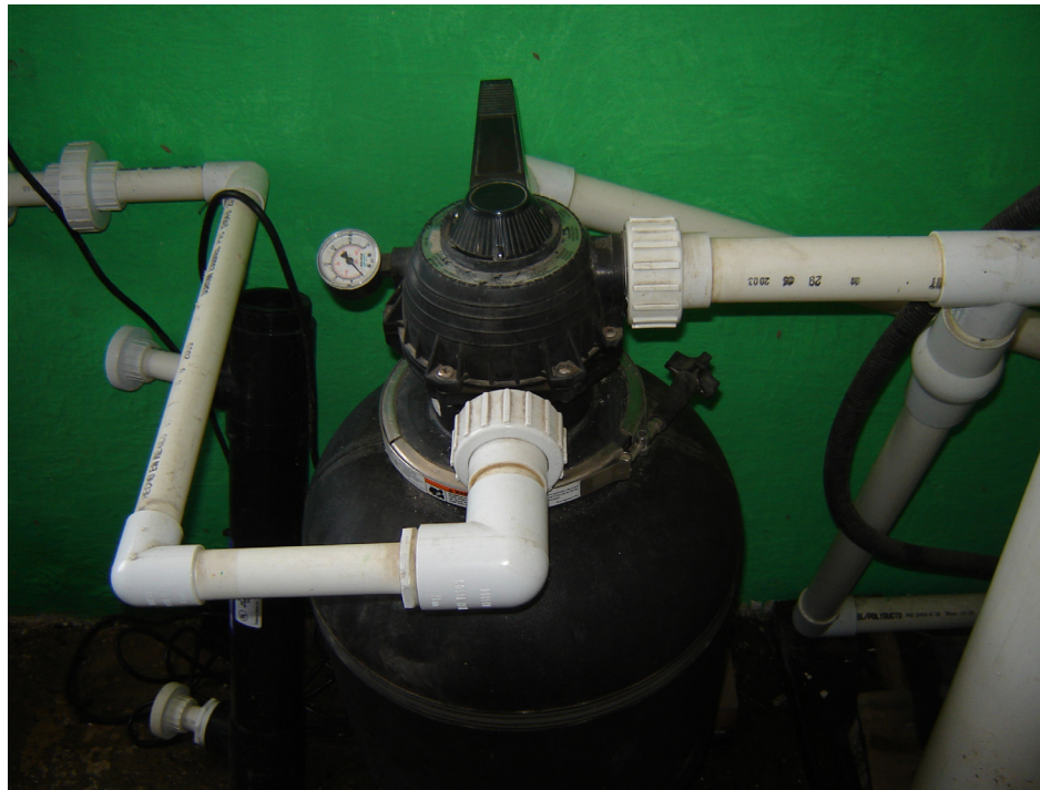
Figura No. 4 Filtro mecánico
