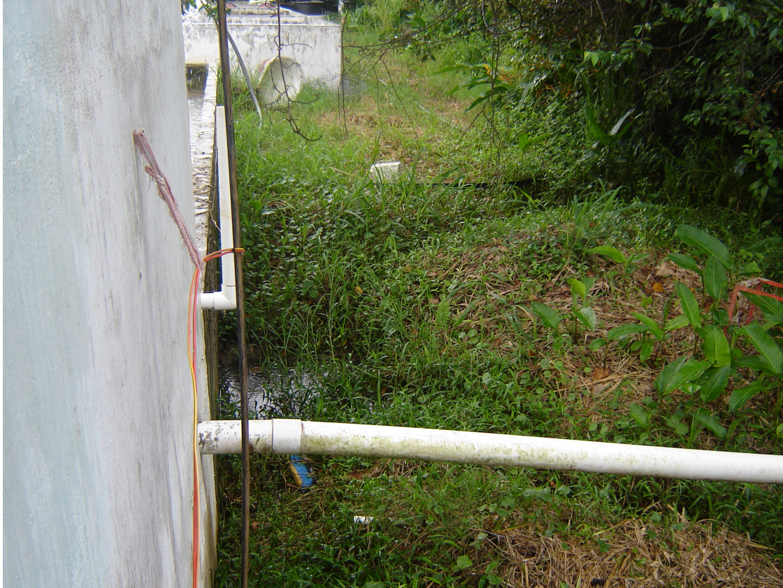
Figura No.6 Descarga de las aguas utilizadas
