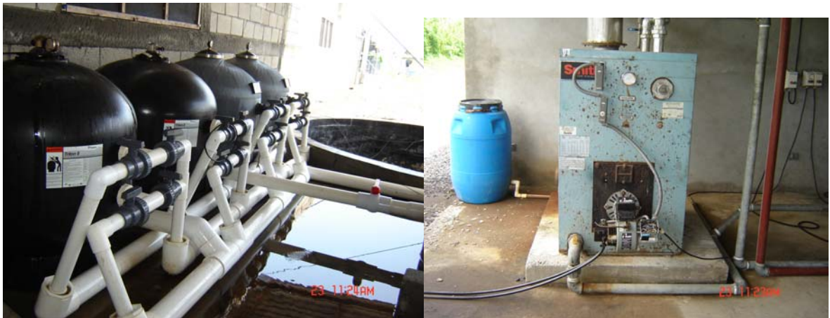
Figura 6. Filtros de arena y Caldera.
