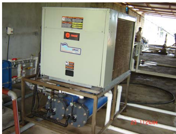
Figura 7. Chiller, para enfriamiento de agua.
