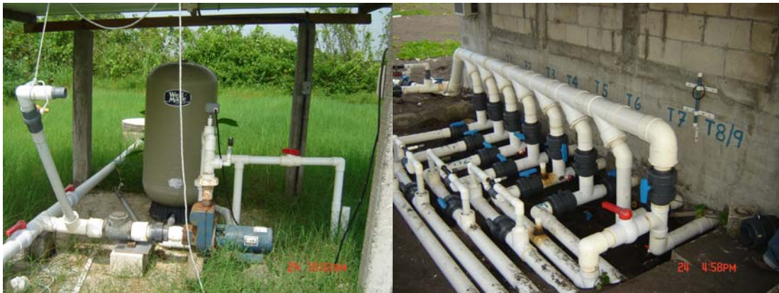
Figura 4. Bombas utilizadas para obtener agua y su respectivo bombeo.
