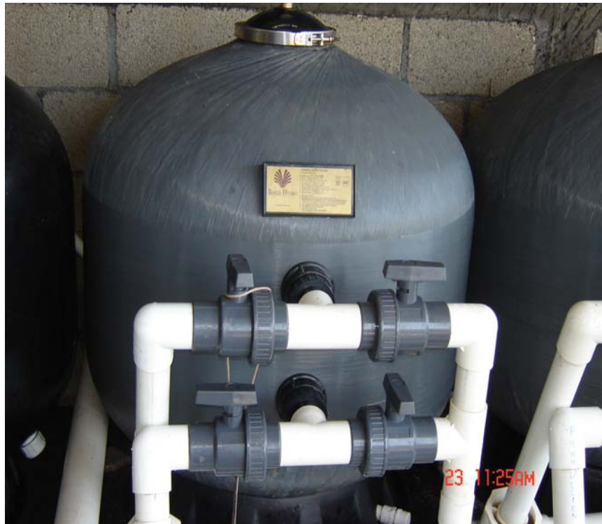
Figura 8. Filtro de arena
