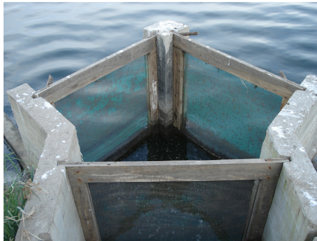
Figura 11. Filtros de compuertas de salida
