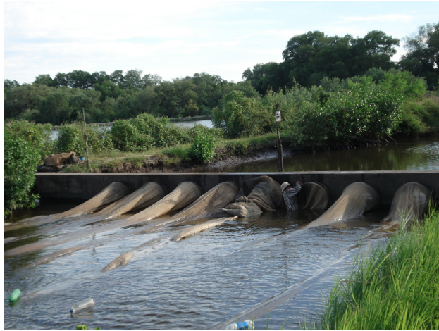
Figura 10. Filtros principales de bombeo
