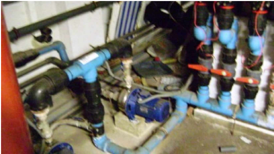
Anexo 5 Sistema de llaves y bombas de pozo de agua dulce
