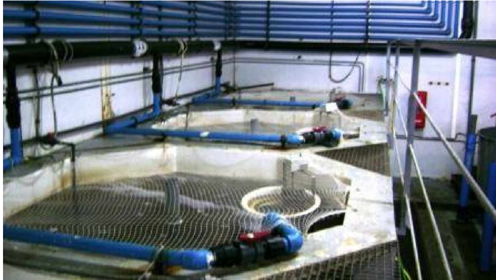
Figura No 4 Línea de Tanques 1B
