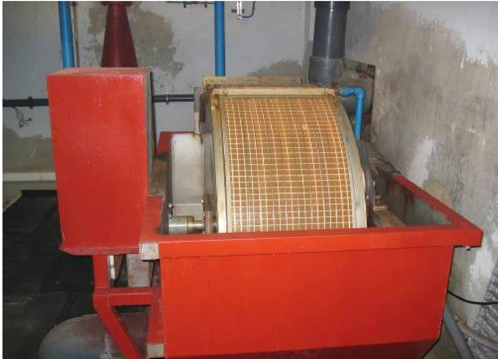
Figura 9: Foto del filtro que se emplea para depurar el agua salada
