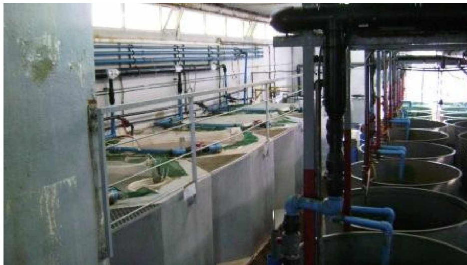
Figura No 5 Línea de Tanques 1A
