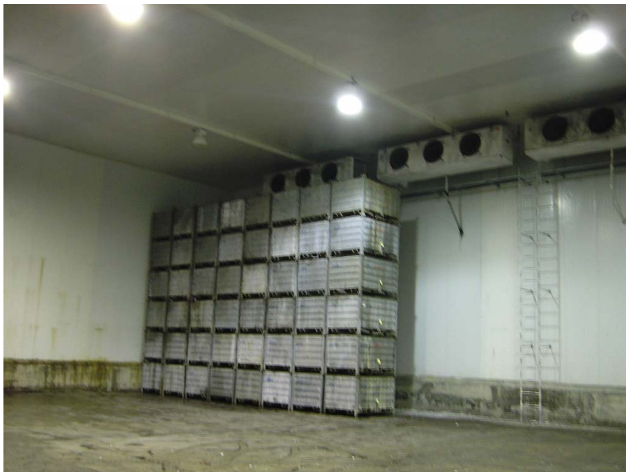
Figura No. 10. Cámara frigorífica con producto clasificado (Trabajo de campo, 2007).
