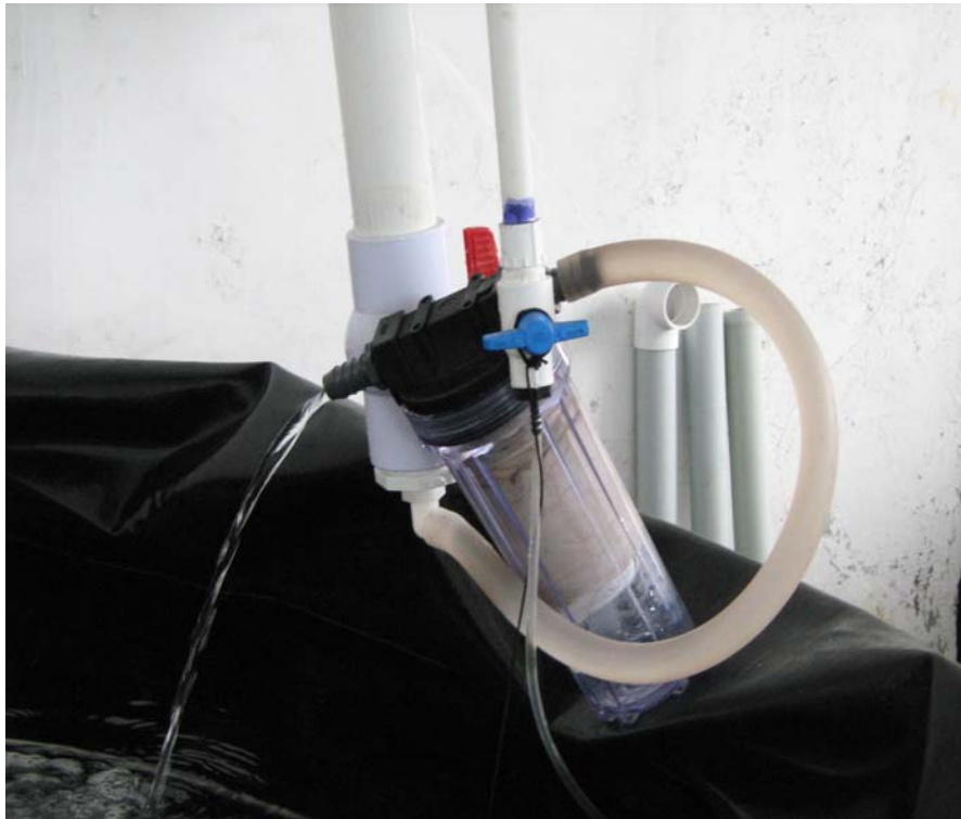
Anexo No. 8 : Sistema de filtros de gasa en las entradas de los tanques.
