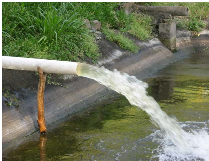
Figura No. 7 Tuberías abastecedoras de agua
