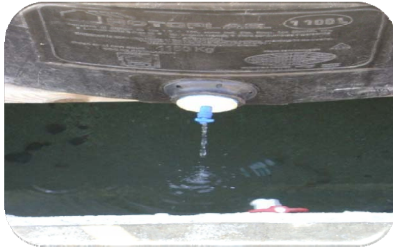
Figura No. 9. Desinfección de agua que sale de tanques de cuarentena
