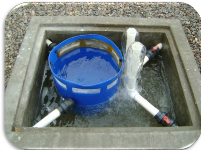
Anexo No. 4 Caja receptora de salida de agua de tanques de cuarentena de jurel
