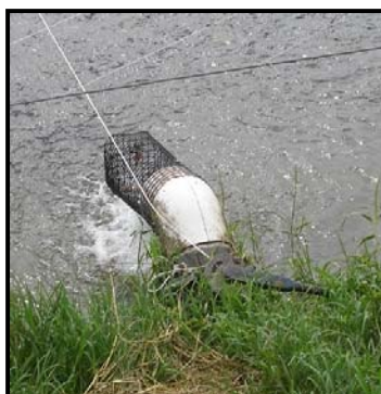
Figura No. 8. Tubería de abastecimiento del área de crecimiento
