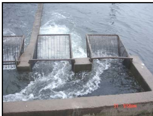
Figura No. 6. Filtro de la entrada principal del canal.
