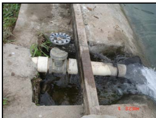
Figura No. 7. Tubería de abastecimiento del área de reproducción
