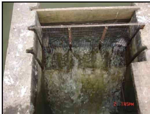
Figura No. 10. Salida de agua, área de crecimiento, reproducción y engorde agua verde
