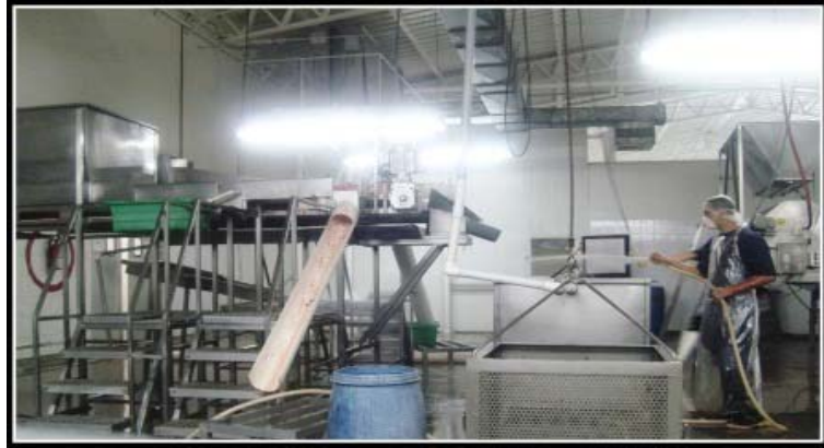
FIGURA No. 13. Maquinaria y equipo de la Planta de Proceso (Trabajo de campo, 2010)
