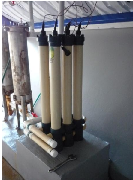
Figura No. 10. Sistema de filtrado UV de seis lámparas (Trabajo de Campo, 2010)
