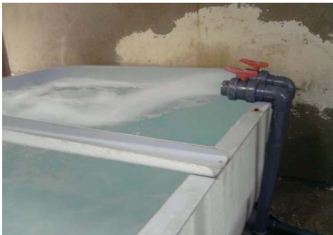
Figura No. 6. Tanques de distribución de agua (Trabajo de Campo, 2010)
