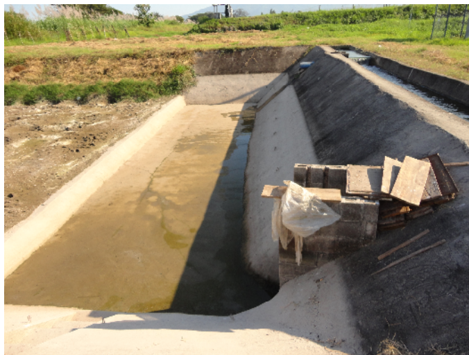
Figura No. 5. Caja cosechadora y monje de concreto (Trabajo de campo, 2011)
