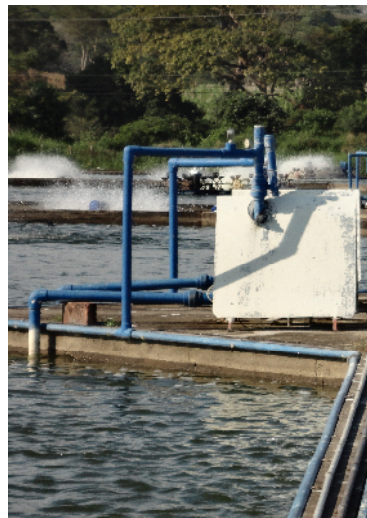
Figura No. 14. Bomba, tubería de PVC y medidor de oxigeno (Trabajo de campo, 2011)
